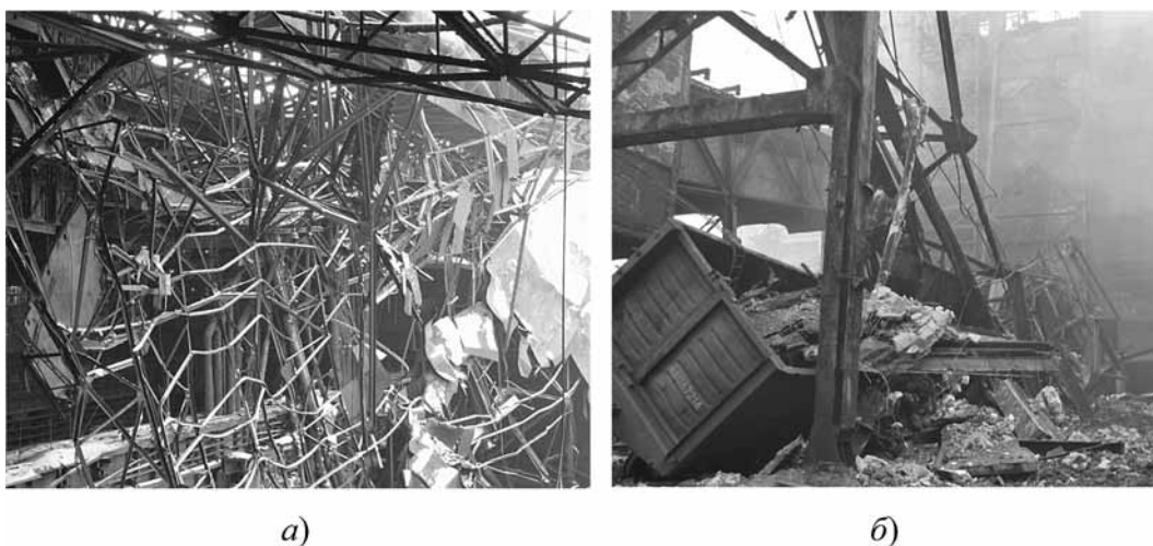
Рис. 1. Последствия аварий конструкций и сооружений:
